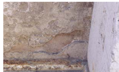
Esempio di degrado
